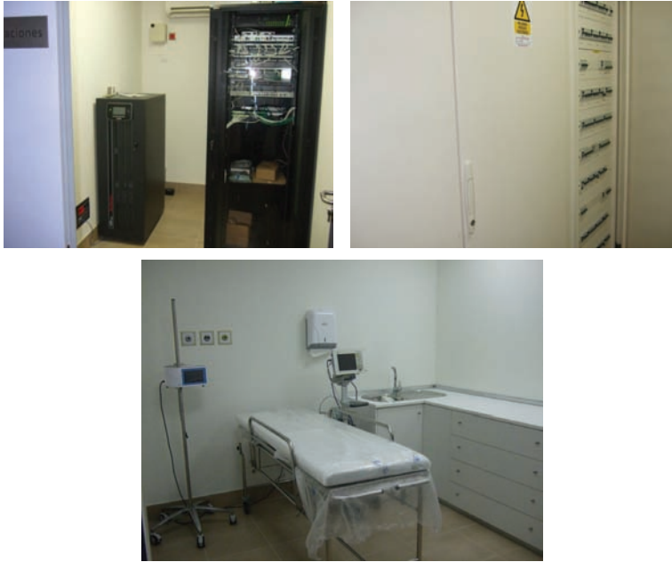
Figura 16. Sala de servidores. Salas de control eléctrico y reanimación
